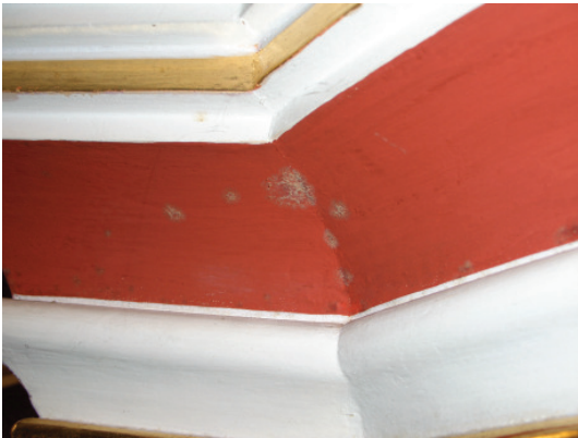
Abb.6: Schimmelpilzbefall an Leimanstrich (Bolsleimrot) am Gesims des Orgelgehäuses
